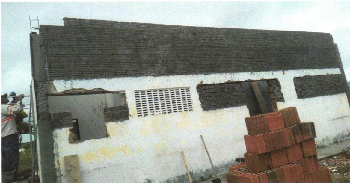
Foto 06- CHAPISCO APLICADO EM ALVENARIA (COM PRESENÇA DE VÃOS) E ESTRUTURAS DE CONCRETO DE FACHADA, COM EQUIPAMENTO DE PROJEÇÃO. ARGAMASSA TRAÇO 1:3 COM PRÉPARO EM BETONEIRA 400 L. AF_06/2014
